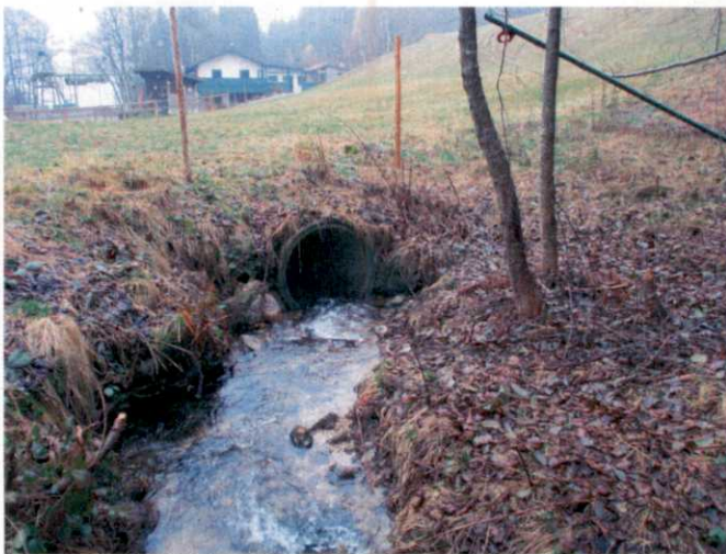
Einlaufbereich zum Staubauwerk lebensgefährlich!
