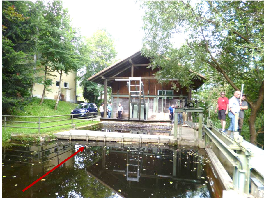
Turbinenhaus mit Grobrechen, Feinrechen mit Rechenreiniger, Grundablassschütze und Eisablassschütze
