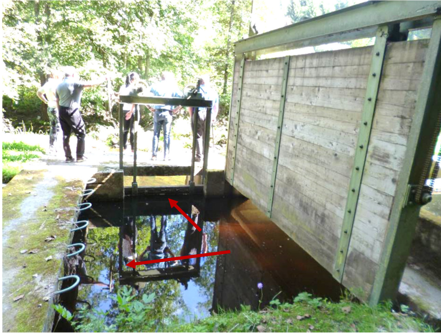
Kanalschütze und Grundablassschütze
