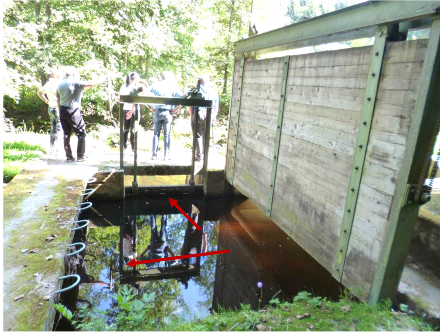
Kanalschütze und Grundablassschütze
